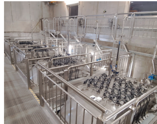
供水系统，奥地利，维也纳，24 万吨/天
