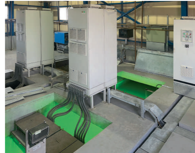
污水处理厂，伊朗，德黑兰，52 万吨/天
