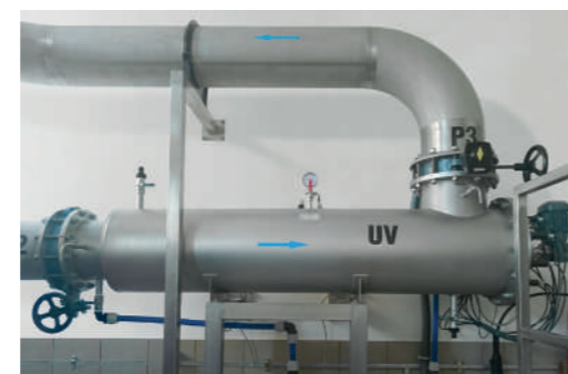
供水处理设施，波兰，尤泽夫夫，1 万吨/天
