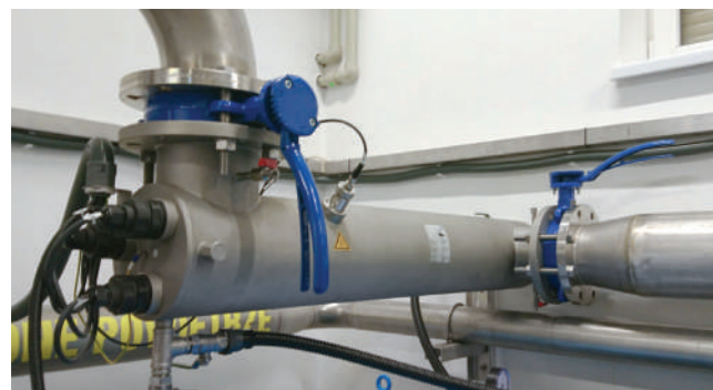
污水处理厂 (WWTP) · 波兰 - 40 立方米/小时
